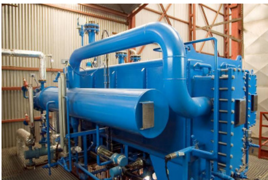
Figure 3: AQUASOL DEAHP, CIEMAT-Plataforma Solar de Almería
